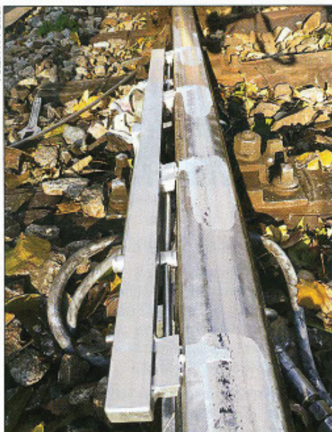
Abb. 2: Aufbringleiste für die stationäre Schienenkopfschmierung.
